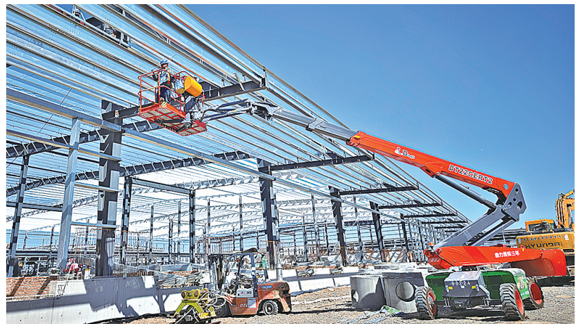
9月11日,在高达科技跨境电商航空物流园项目建设现场,工人正加紧施工。
